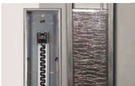
ЭЛЕКТРИЧЕСКИЕ ПАНЕЛИ ELECTRICAL PANELS
